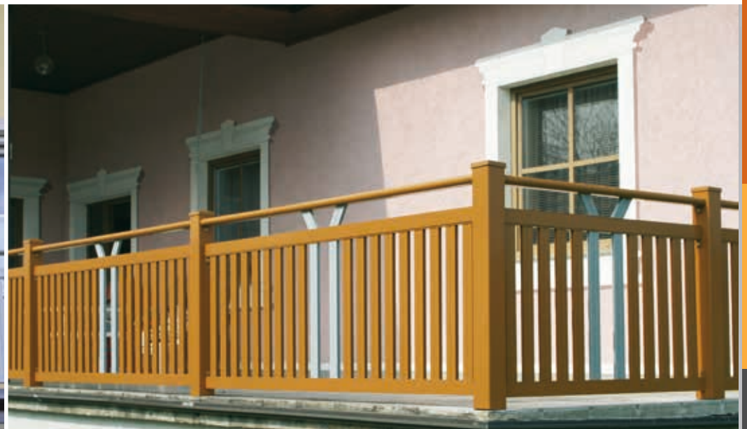
312 Schladming Balkongeländer S2
